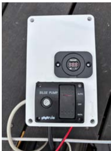
Kontrolboksen som indeholder laderegulator, sikring, kontakt og voltmeter
