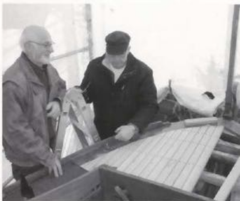
Ellidas nye massive dæk af lærk er helt i tråd med bådens oprindelige byggestil.
