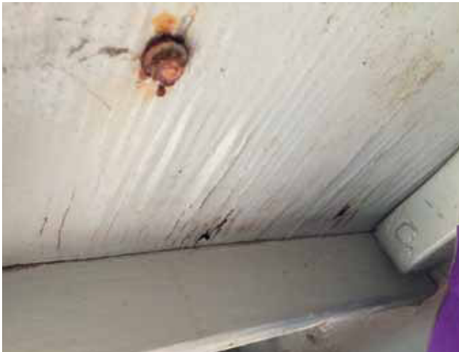
Plywooddækket under teakstavene var nogle steder helt blødt. Det skulle skiftes, hvor det var galt
